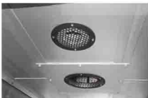
ช่องลมร้อนหมุนเวียน
